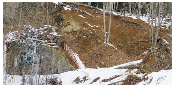
▲2016年から放置されている被災現場
